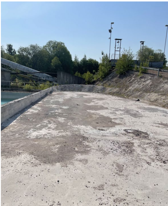
Kuva 6: Pesupaikan ja maataskujen välinen altaista nostetun hienoaineksen kuivatuspaikkana toimiva betonilaatta. Betonihienoaines on viety pois.
