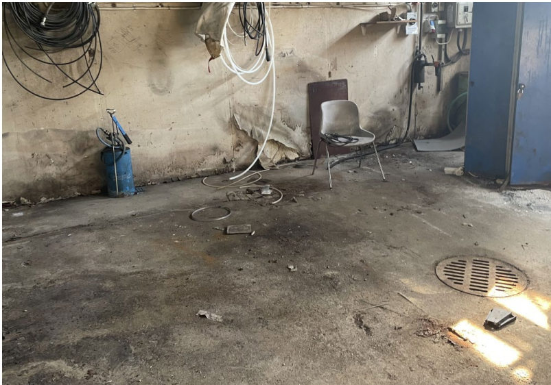
Kuva 7: Öljyhavainto betonilattiassa korjaamotilassa.
