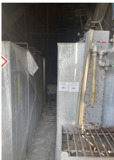
Kuva 3. Lisäainesäiliöt niiden varastohuoneessa (peltiset valuma-altaat, joiden sisällä muoviset lisäainesäi-liöt
