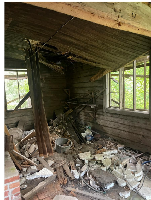
Kuva otettu 2.7.2023. Sortunut yläpohja näkyy selvästi.
