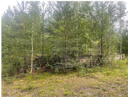
Kuva otettu 2.7.2023. Kuvassa näkyy palon jäljiltä jäänyt korkea kivijalka. Muuten rakennus on purettu.
